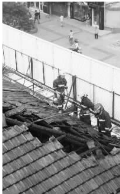
被烧塌的屋顶
