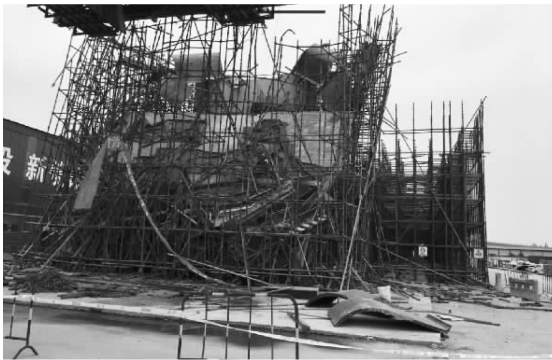
杭海城际铁路长安段坍塌现场。
